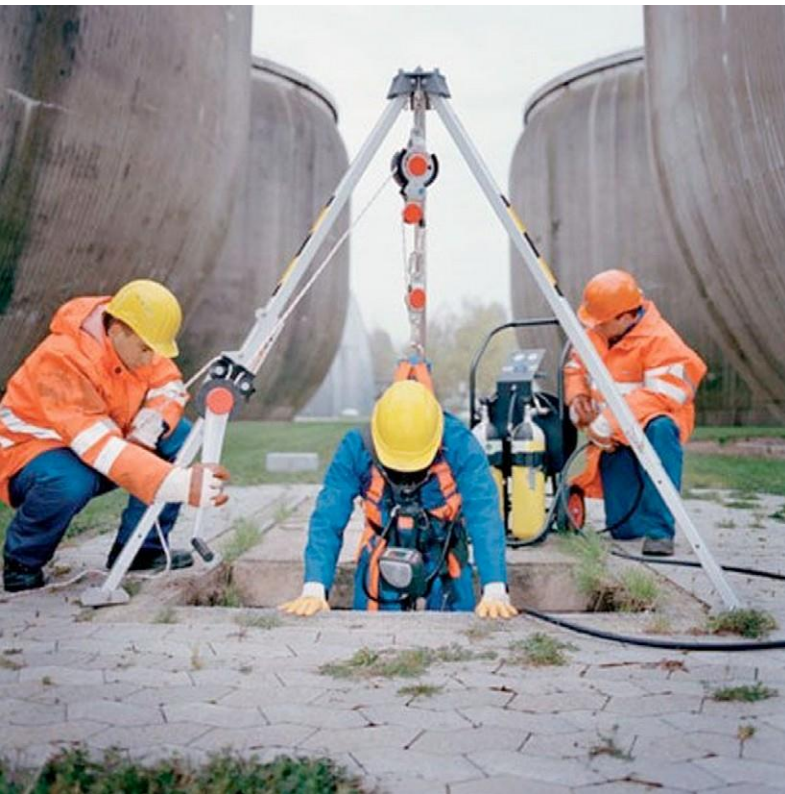
Imagen 10. Peligros de lugares confinados. Fuente: http://prevencionar.com.mx/media/sites/3/2015/02/fdgdgfg.jpg
